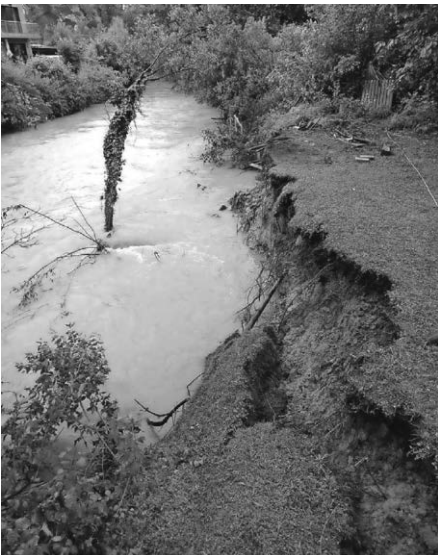
Beispielhafter Uferschaden an einem Bach durch das Hochwasser und die Starkregenereignisse.
